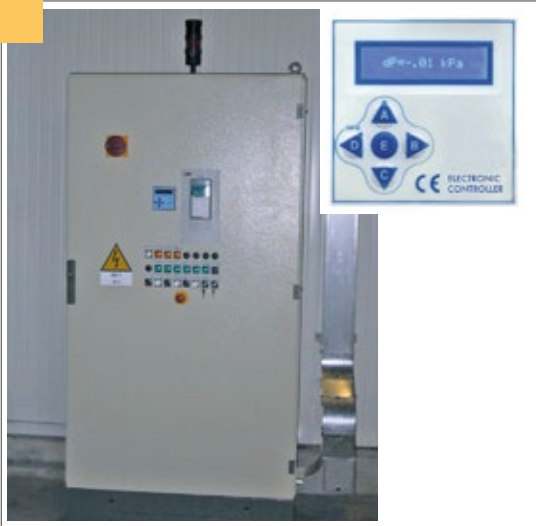
QUADRO ELÉTRICO COM VARIAÇÃO ELETRÓNICA ARMOIRE ELECTRIQUE CONTROL BOARD AND PRESSURE STABILIZER WITH INVERTER SCHALTSCHRANK MIT FREQUENZUMFORMER UND DRUCKSTABILISATOR TABLERO ELÉCTRICO
